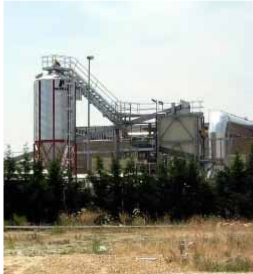
Figura 37: planta de tratamiento de purines y cogeneración eléctrica de Turégano (Segovia) Fuente: Norte Castilla
